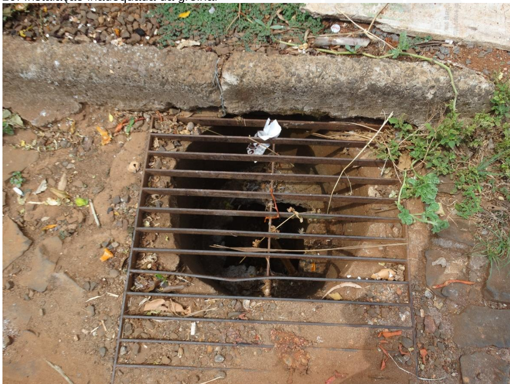
Figura 10: Instalação inadequada da grelha.
