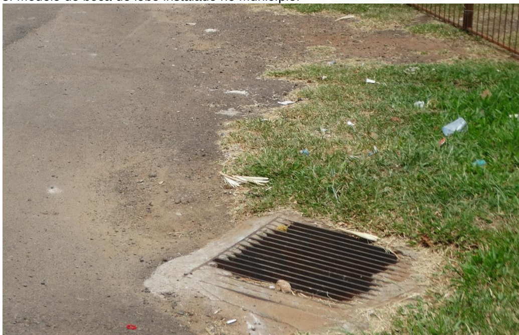
Figura 8: Modelo de boca de lobo instalado no Município.
