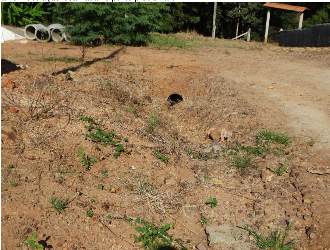
Figura 16: Tubulação localizada no ponto-problema-01.
