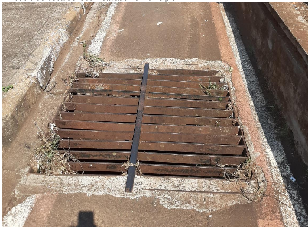
Figura 7: Modelo de boca de lobo instalado no Município.
