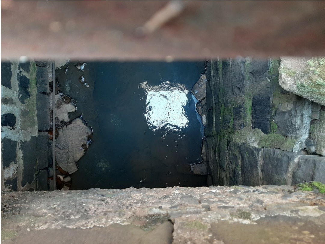
Figura 37: Canal que extravasa no ponto-problema 9.
