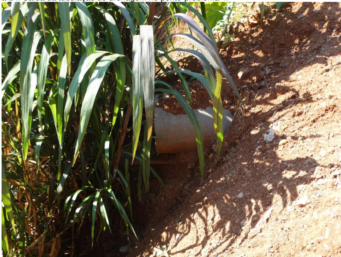
Figura 24: Saída da tubulação de drenagem no ponto-problema 4.
