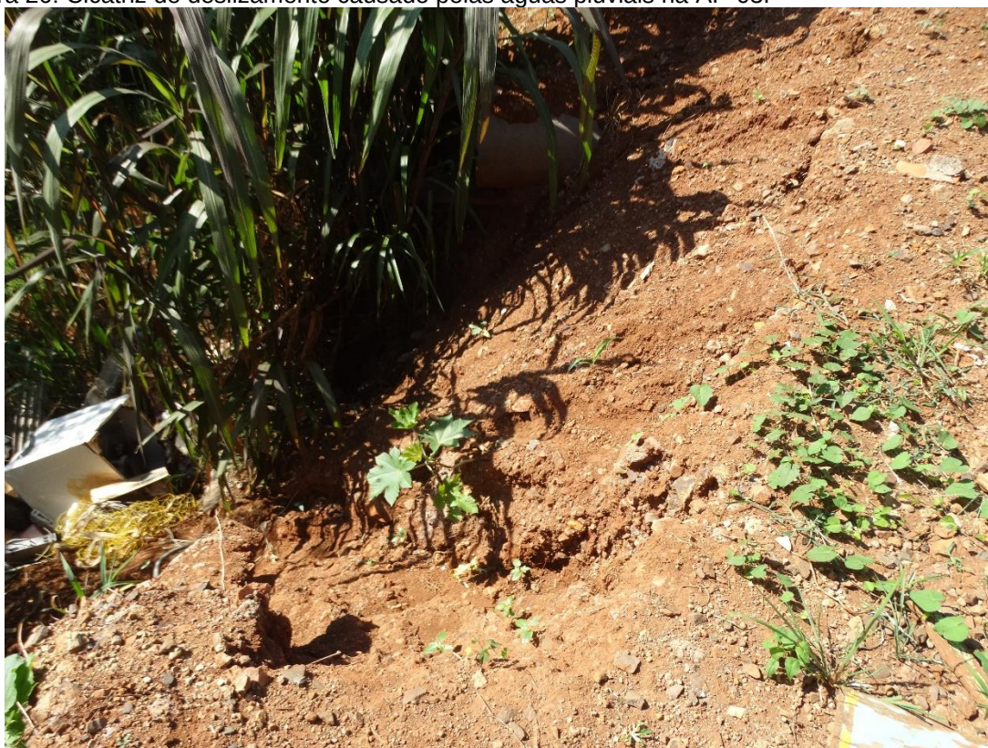
Figura 26: Cicatriz de deslizamento causado pelas águas pluviais na AP-03.
