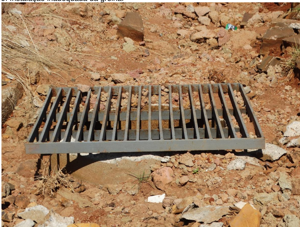
Figura 9: Instalação inadequada da grelha.
