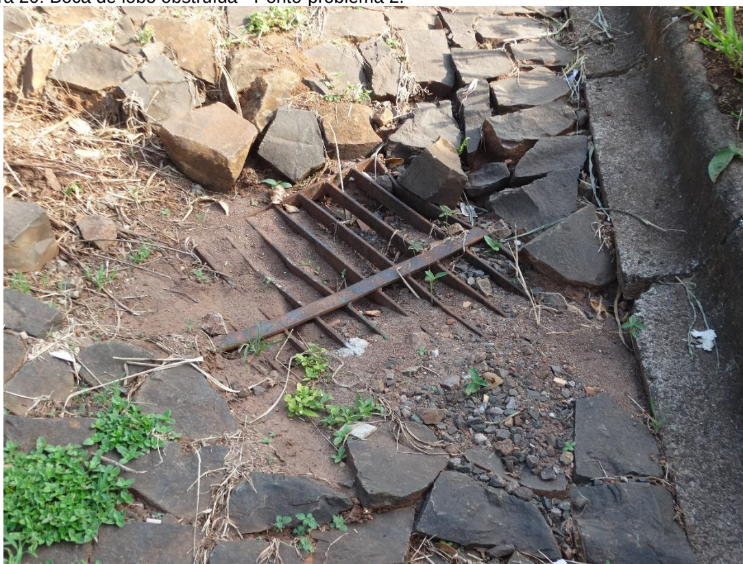
Figura 20: Boca de lobo obstruída - Ponto-problema 2.
