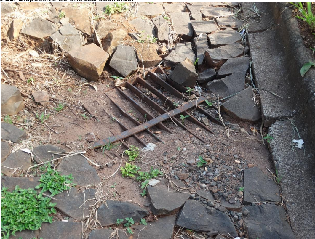
Figura 11: Dispositivo de entrada obstruído.
